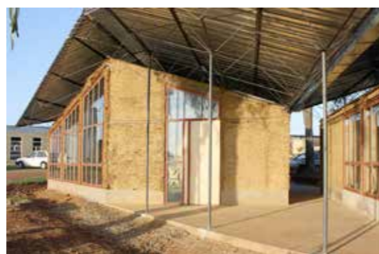
Projektbau auf dem Gelände des Ithuba Skills College unter Beteiligung der RWTH Aachen
